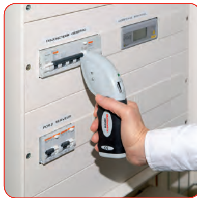
2-Detecte el fusible o interruptor
