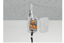
Conexión de lámpara en falso techo
